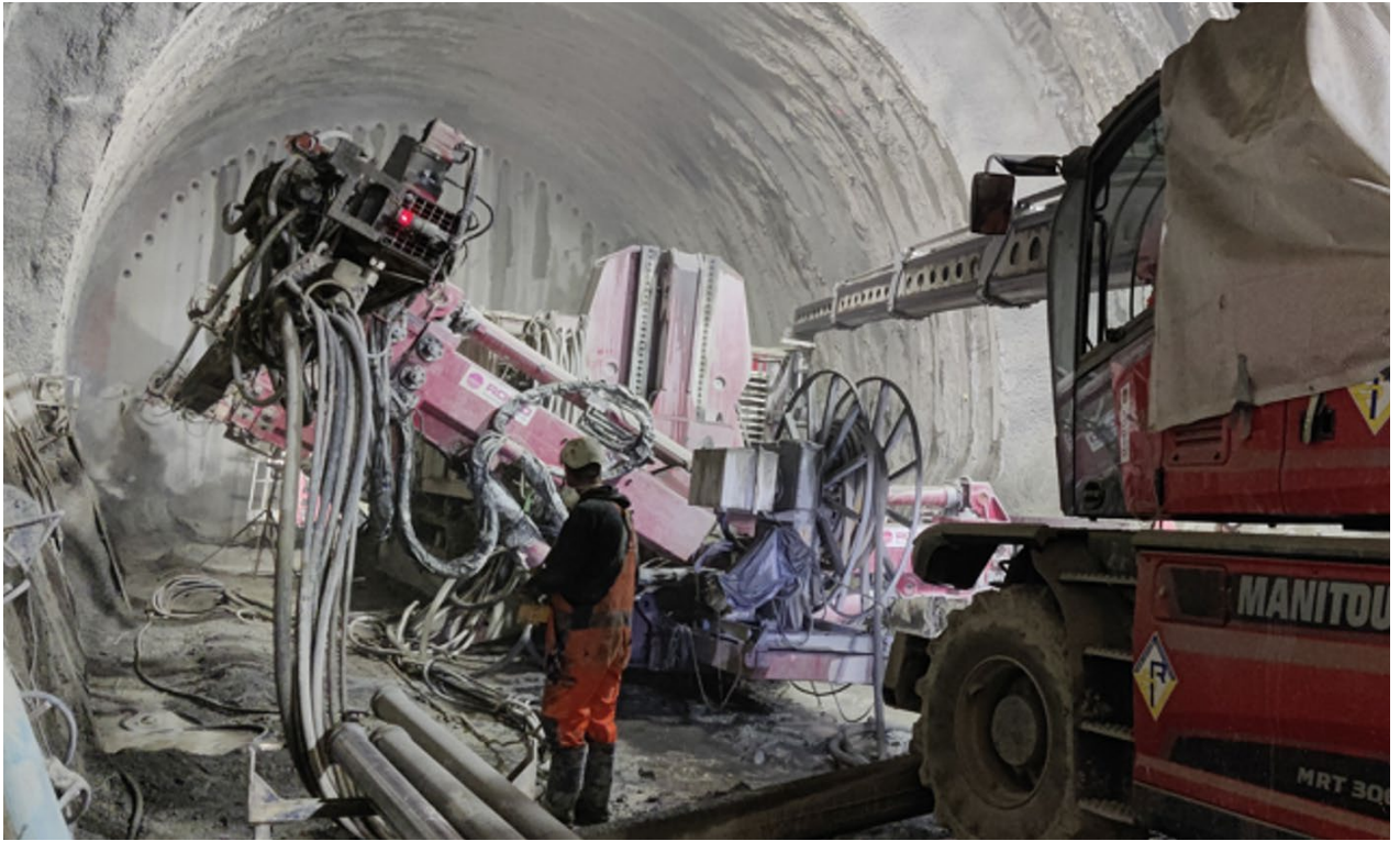
Der linke Arm arbeitet, während der rechte Arm mit dem nächsten Stahlrohr beladen wird.
