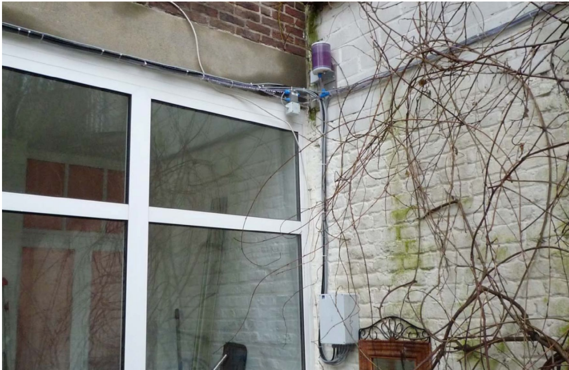
Schlauchwaage montiert an einer Hauswand
