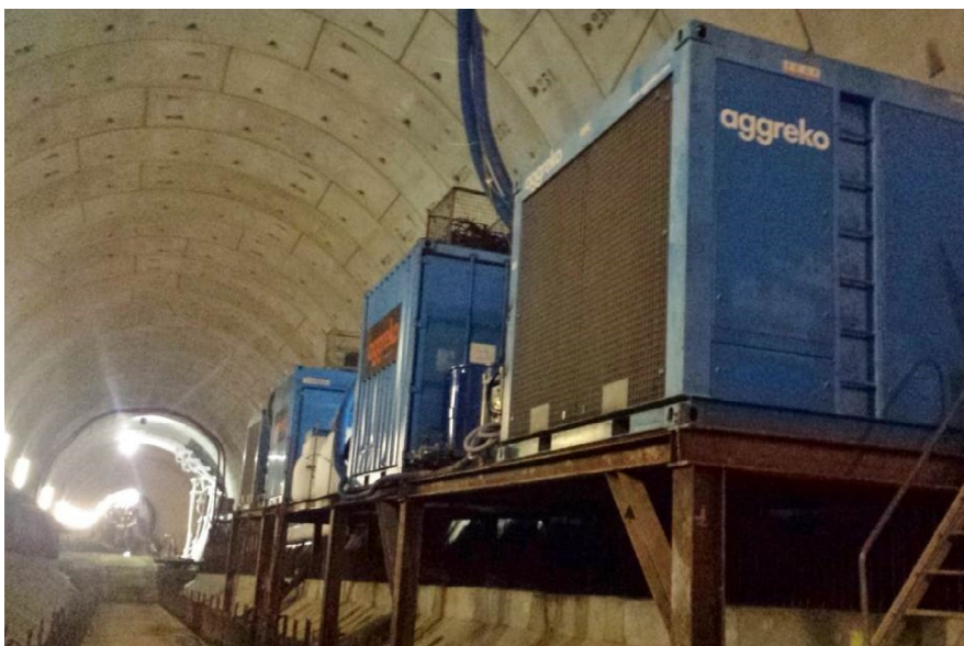
Gefrieranlagen in dem Haupttunnel
