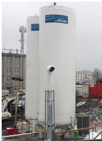
Silos für flüssigem Stickstoff
