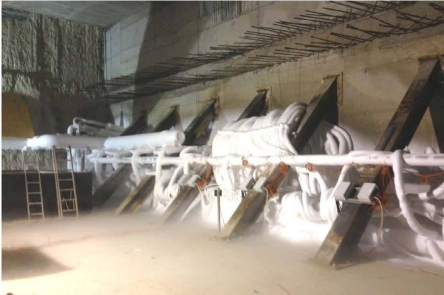
Soleverteiler mit flüssigem Stickstoff West Schacht
